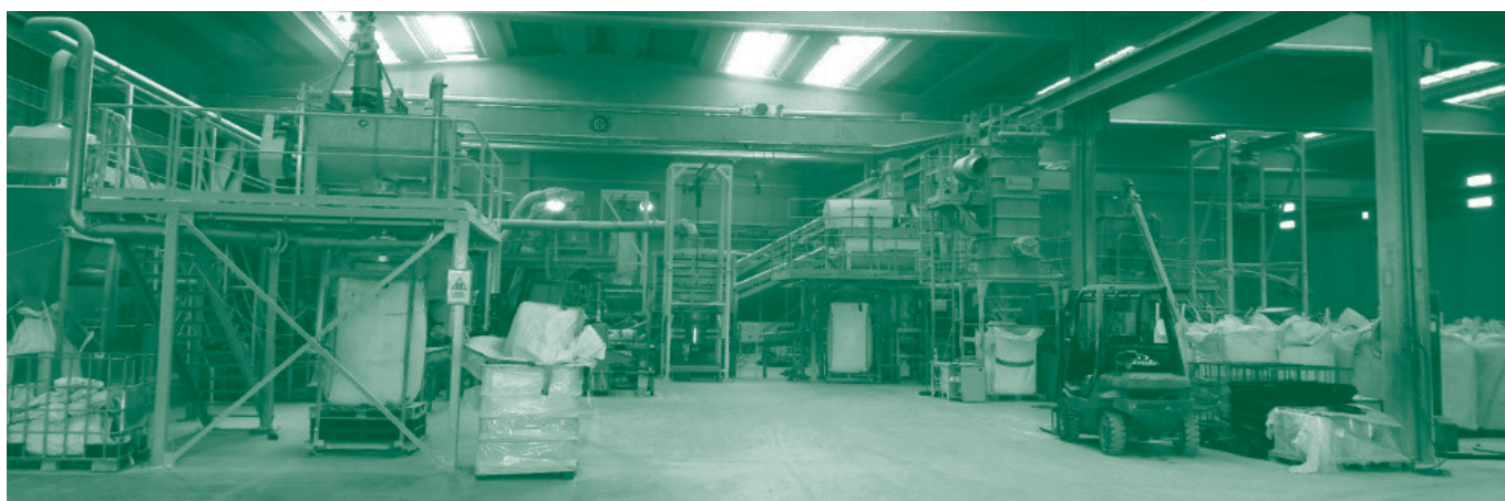
Vista General de la Planta de azufre, Líneas 1 y 2 de fabricación.
